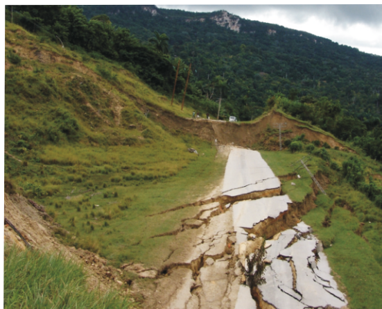
Deslizamiento en Guantánamo
